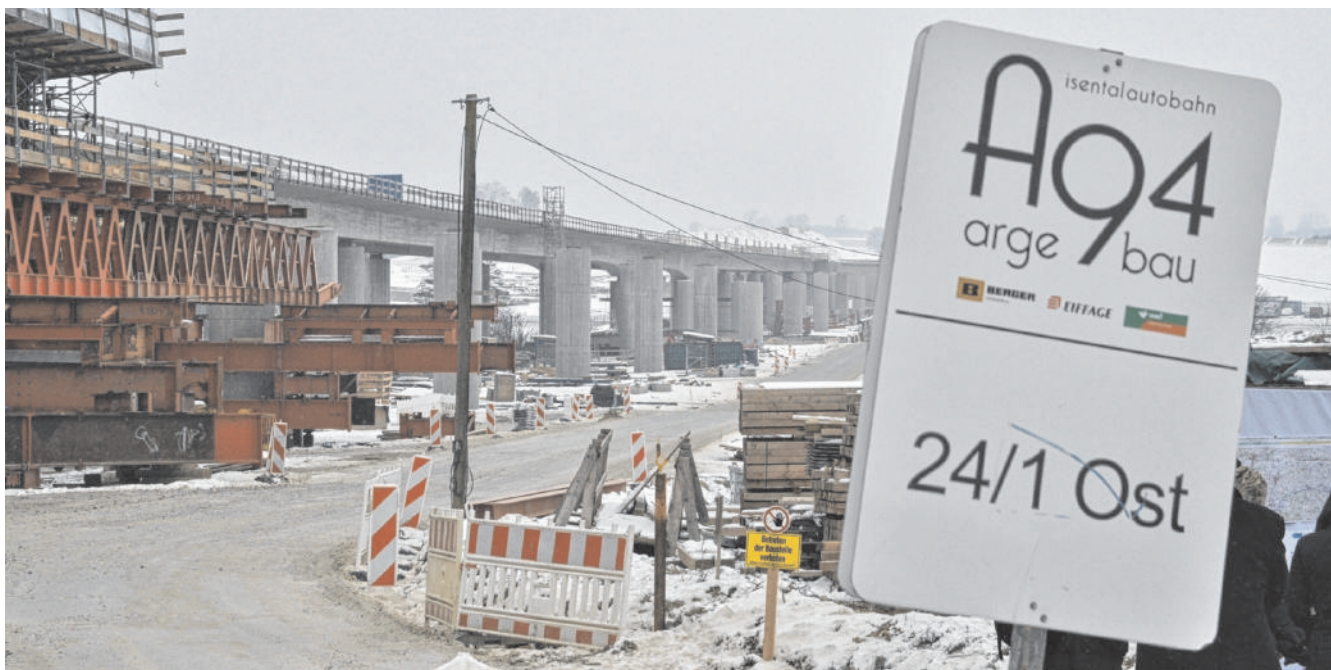
In Schiefelage ist nur das Hinweisschild: Die Isentalbrücke und die gesamte A94 sind laut Baufirmen im Zeit- und Kostenplan.
